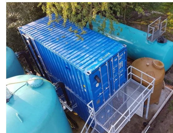
Anlage zur LHKW-Entfernung durch Wasseraktivkohlead-sorption mit vorgeschalteter Kiesfiltration
